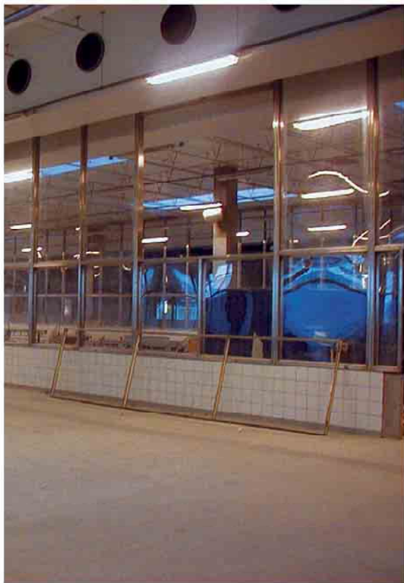
Danish Crown slagteriet ved Horsens. Vink har leveret ca. 3000 kvadratmeter Lexan Polycarbonat i seks millimeter, som er anvendt i ramsesystem til indvendige klare skillevægge.
